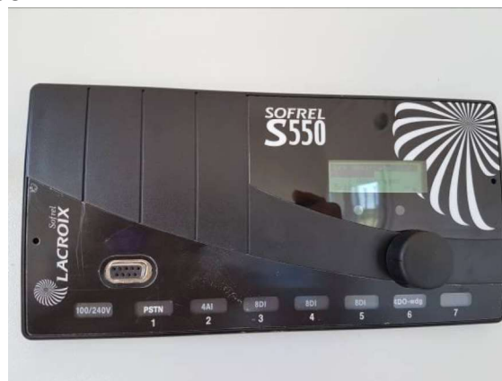
Armoire de commande (Automate SOFREL)
