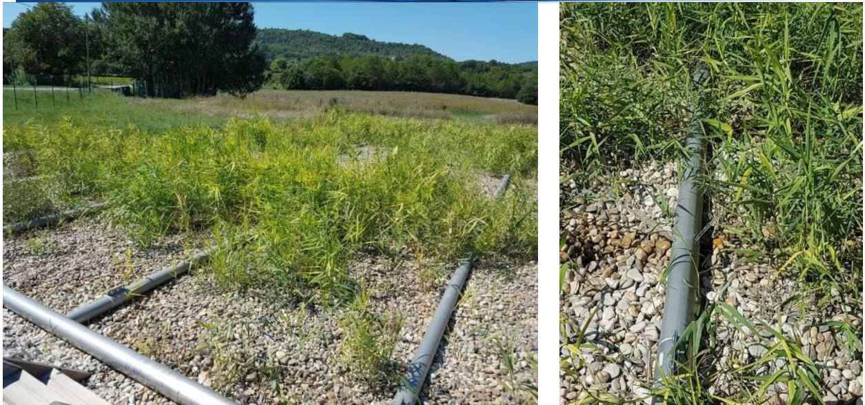
2 nd étage de filtre planté de roseaux
