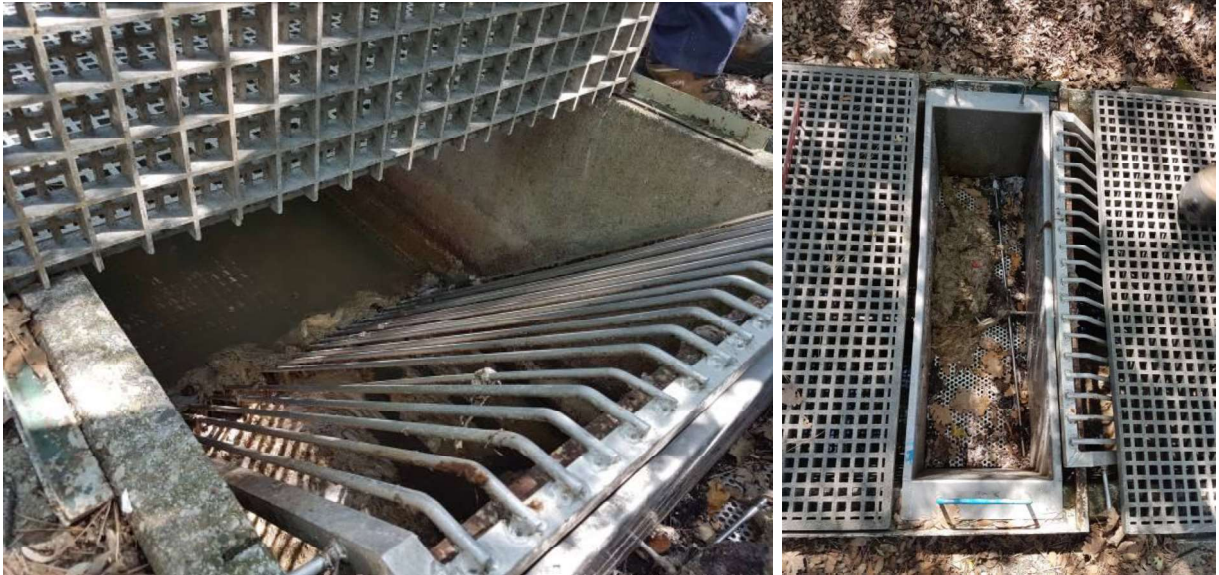
Vue du dégrilleur et du panier d'égouttage
