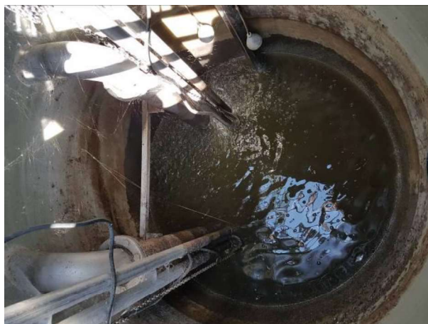
2 nd poste de relèvement
