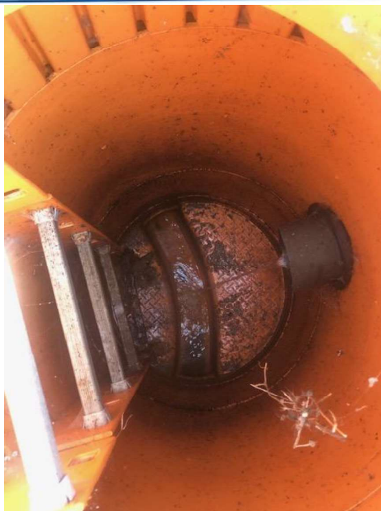
Arrivée d'eau claire au niveau du regard en entrée de STEP
