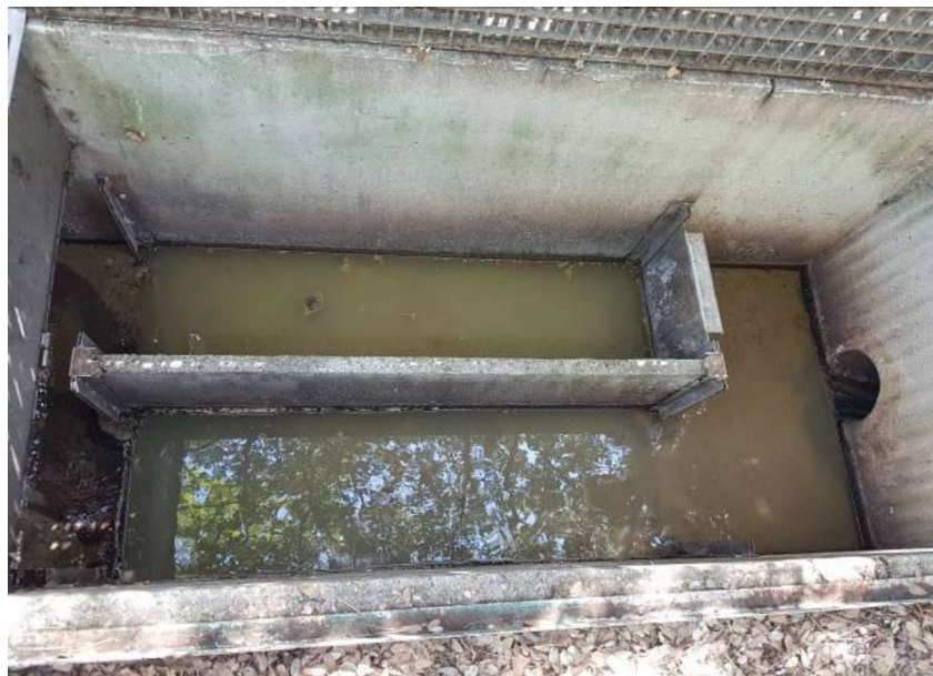
Vue du système de dessablage
