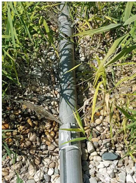
Visualisation de la sortie d'eau par les trous de la canalisation)
