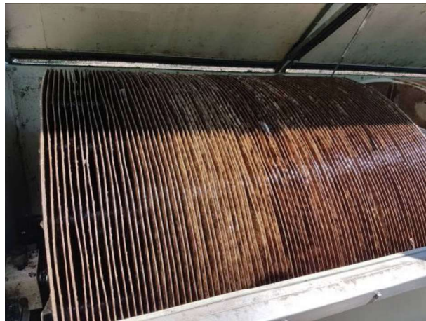
Vue intérieure des biodisques
