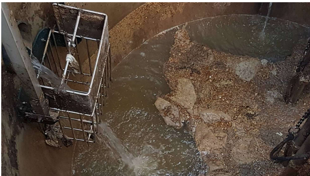
Vue des lingettes et du panier de dégrillage en entrée de STEP (1 er poste de relèvement)
