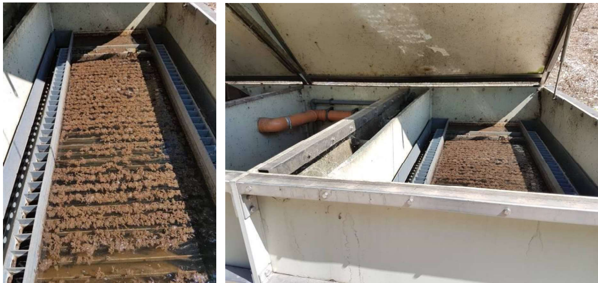
Vue du décanteur lamellaire
