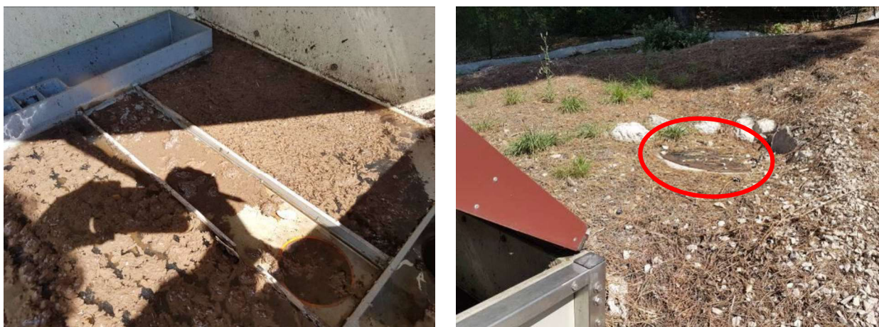
Vue de Goulotte de d'évacuation des flottants et la buse de récupération
