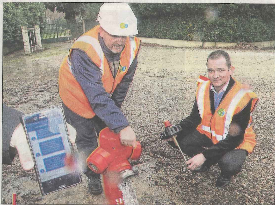
Dès qu'un poteau incendie est ouvert, le dispositif alerte immédiatement les services du Syndicat Rhône Ventoux par SMS et mail.
