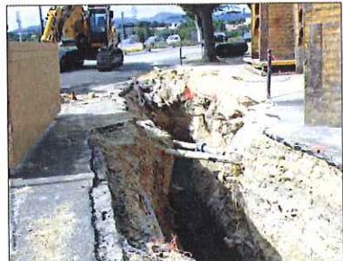
En juin 2015, à cause d'une fuite, la chaussée s'était effondrée à l'angle du boulevard du Nord.
